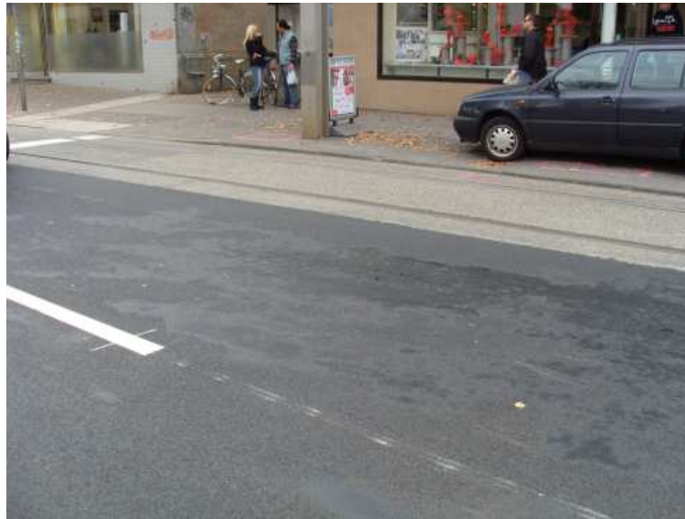
Wickeder Hellweg – Bindemittelanreicherung, zu viel Material zu Einbaubeginn
