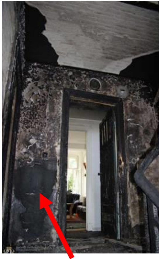
Hohe Brandintensität im Treppenraum
