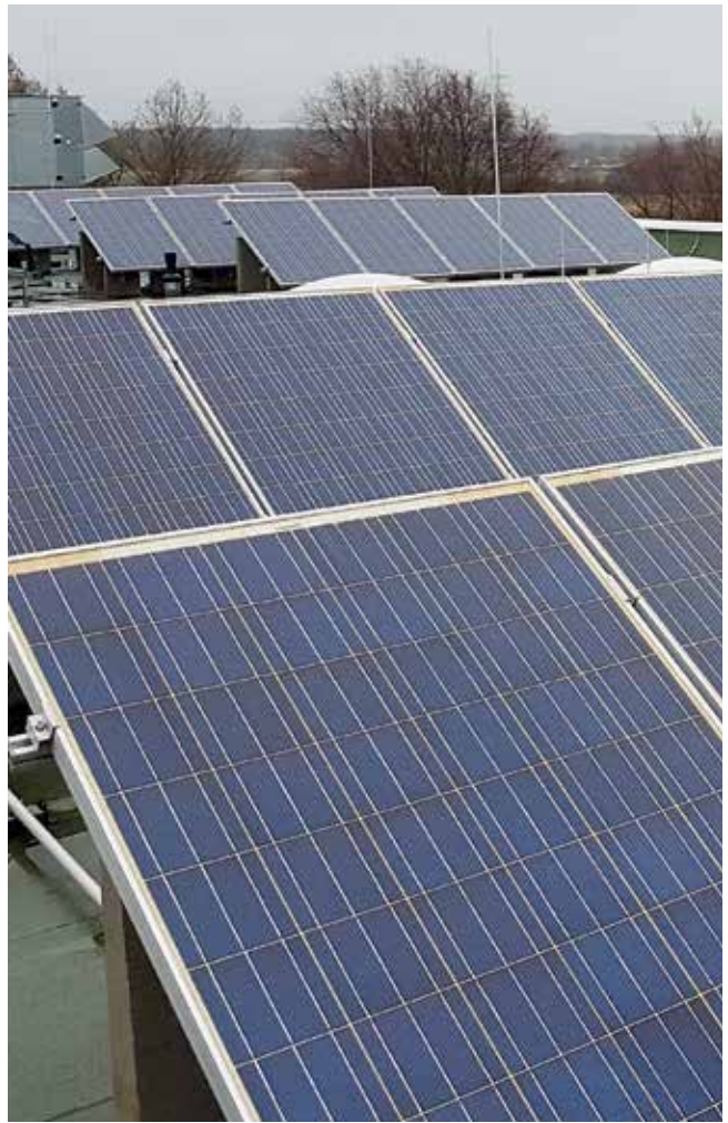
Dachbegrünung und Photovoltaik auf öffentlichen Gebäuden Foto: Stadt Dortmund
